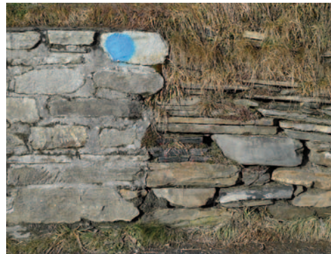
Ungünstig sanierte Mauer (GR).
